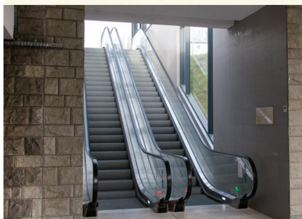
Schody ruchome przy stacji metra Służew
