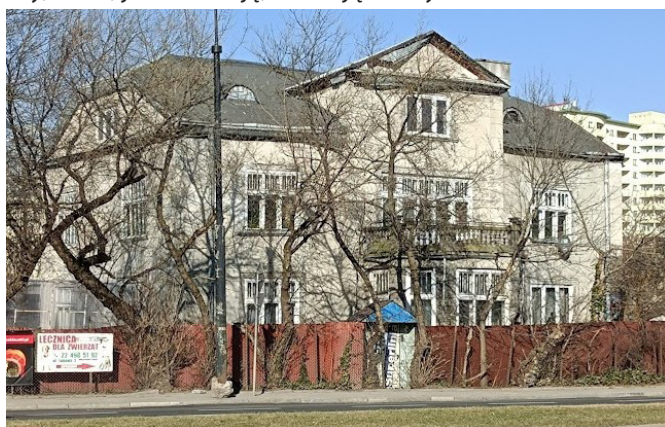
Stan obecny – pomimo otrzymanych w 1939 roku dwóch pocisków czołgowych, a w czasie Powstania jeszcze czterech, dom zachował niezmienny charakter.
